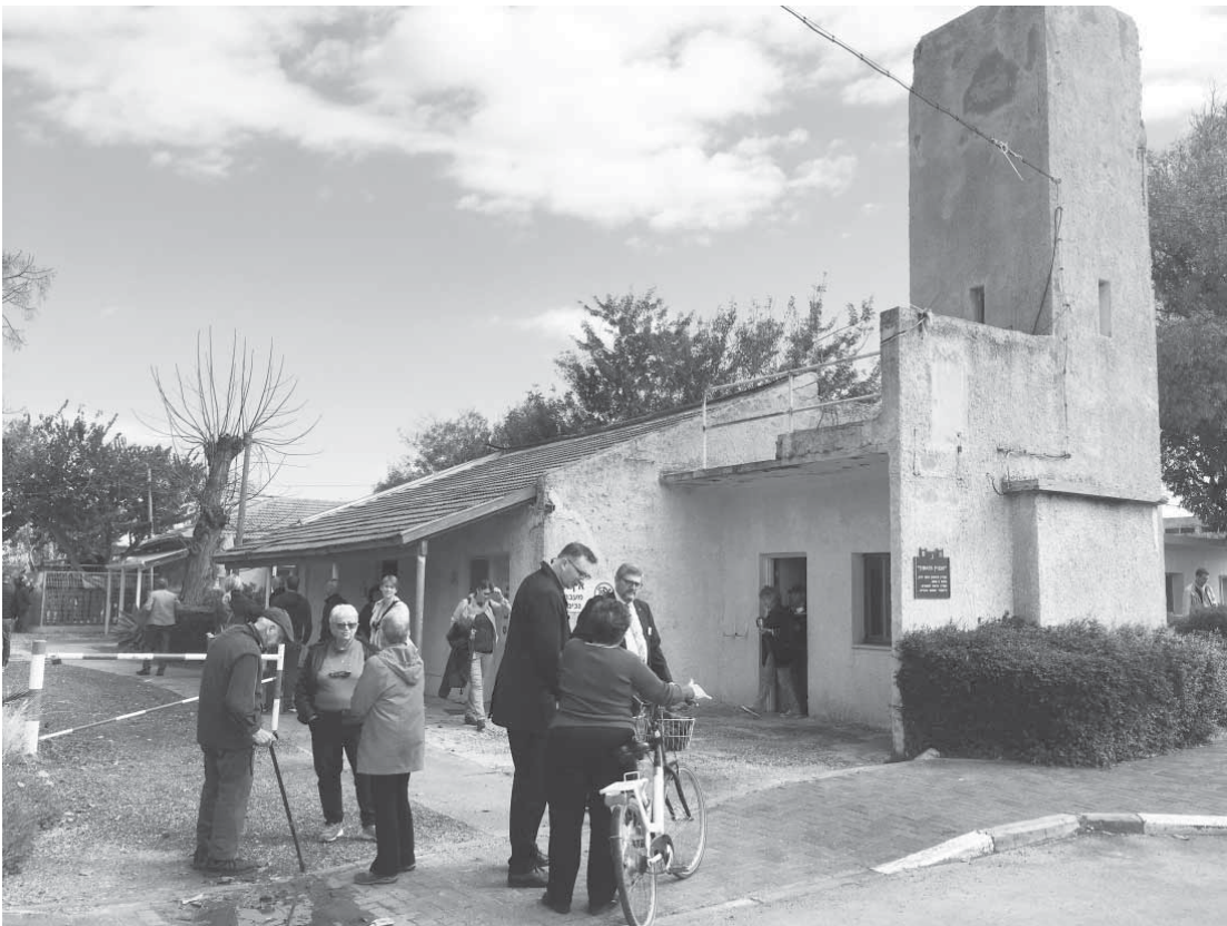
Der 1940 erbaute Wachturm ist denkmalgeschützt. Im angebauten Nebengebäude ist das Archiv von Shavei Zion untergebracht. Dort werden bedeutende Dokumente aus der Gründungszeit der Gemeinde aufbewahrt. Das ganze Ensemble ist dringende renovierungsbedürftig. Das Land Baden-Württemberg und der Rexinger Synagogenverein haben der Genossenschaft von Shavei Zion, die für das Gebäude verantwortlich ist, finanzielle Unterstützung bei der Renovierung zugesagt.
